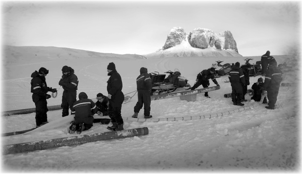
Dotación de Base Carlini en tareas de reparación por congelamiento de cañerías
